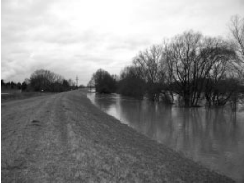
Maindeich in Schweinfurt bei Hochwasser eingestaut (Januar 2003)
