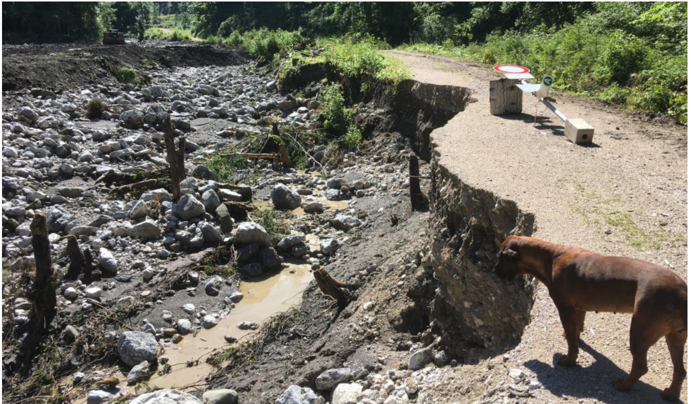
Abb. 2: Der ehemalige Forstweg wurde durch das Ereignis teilweise weggerissen (© WWA Weilheim)
