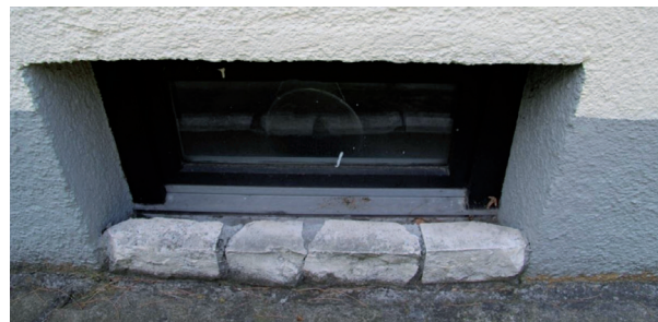
Bild 5: Einfache Schutzmaßnahme am Kellerfenster
